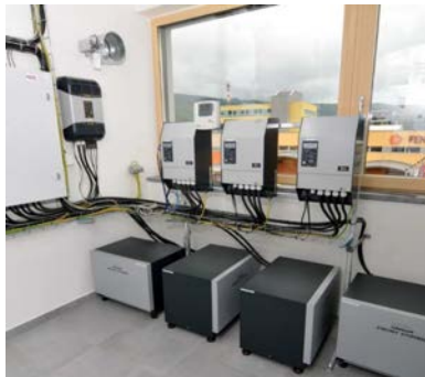
Administrativní budova, 24 kWh
