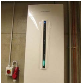
Domácí úložiště 6 kWh
